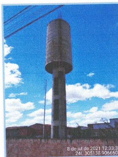
Figura 3-6- Reservatório 2 da sede de Dormentes Fonte: COBRAPE (2021)
