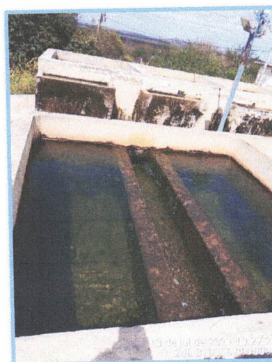
Figura 3-3- Filtros da ETA Morro do Crioulo
