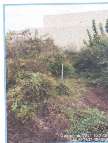
Figura 3-25- Fossa rudimentar da UBS na comunidade Caatinga Grande
