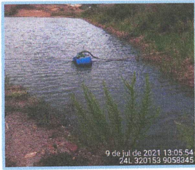
Figura 3-17- Captação - Vila Nova Fonte: COBRAPE (2021)
