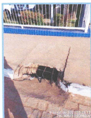
Figura 3-41- Boca de lobo na rua Maria Honorina Novaes Granja
