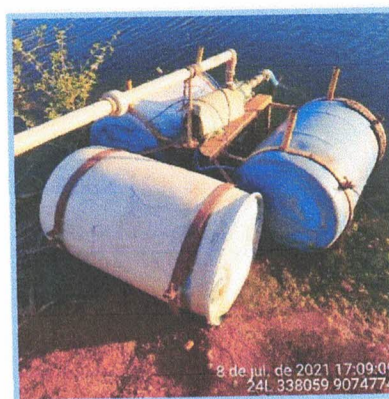
Figura 3-16- Captação - São Domingos
